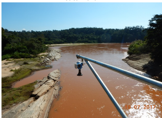
Figura 4: Registro de sensor de nível por radar.
